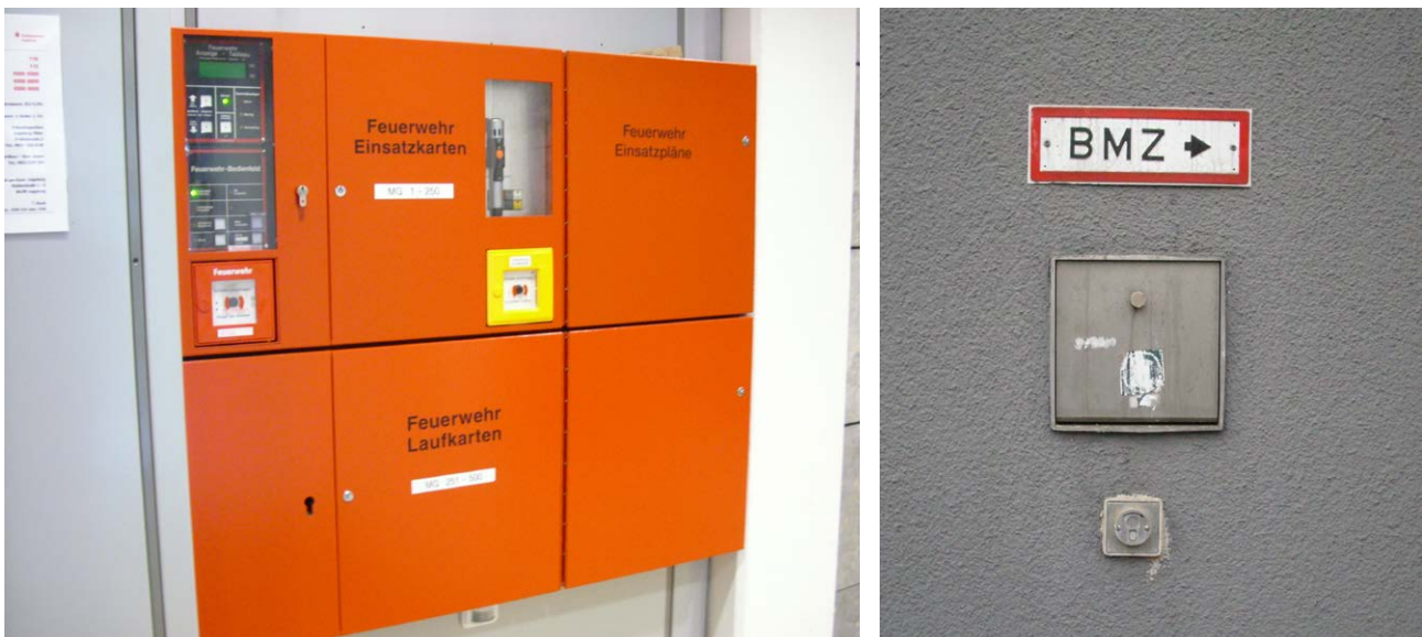
Bild 8: Eingebautes Feuerwehrschränke mit Freischaltelement und Hinweisschild sowie Feuerwehrinformationszentrale wie man sie vorfindet
