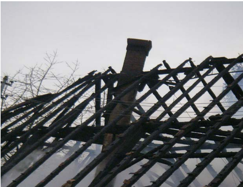
Abbildung 16: Schornstein kurz vor dem Einstürzen nach einem Dachstuhlbrand
