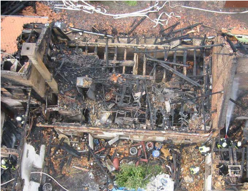
Abbildung 17: Komplett eingestürzter Dachstuhl nach einem Brand – Die Schäden am hölzernen Dachstuhl lassen auf eine Branddauer von bis zu 50 min schließen
