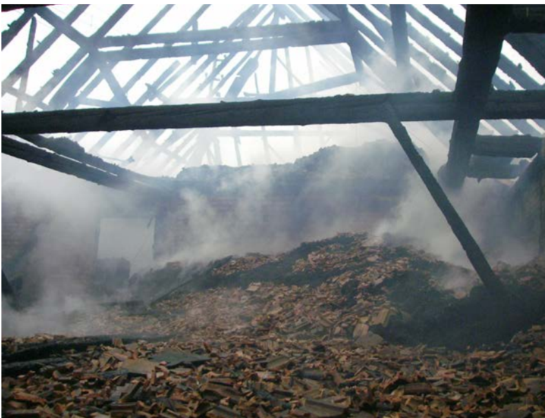
Abbildung 13: Abgestürzte Ziegel nach einem Dachstuhlbrand
