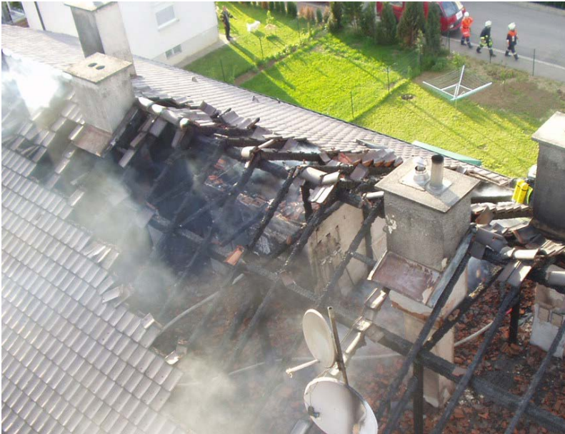
Abbildung 2: Der Dachstuhlbrand hat sich zur linken Giebelseite hin ausgebreitet Quelle: Feuerwehr Lauingen (Donau)
